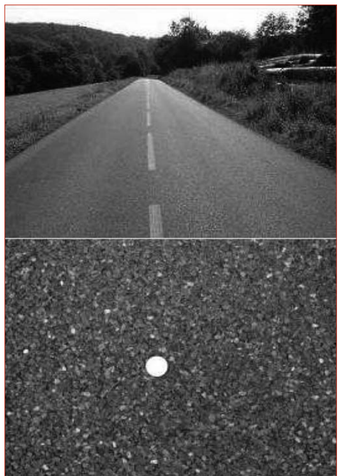
Photo 12 : Aspect de la chaussée après 30 mois.
