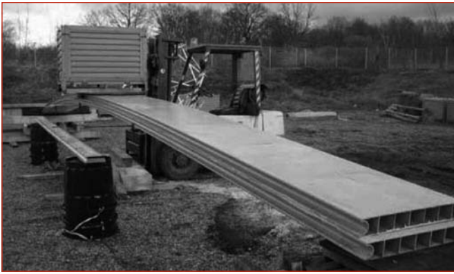
Figure 12 : Chargement de la poutre afin de mettre en place le câble central.
